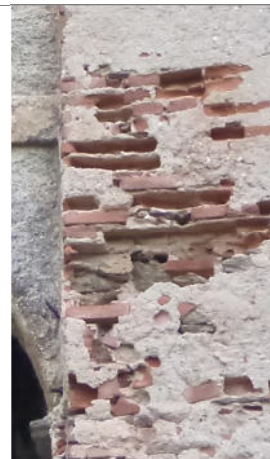
Erosione epolverizzazione dei mattoni - Roasio
