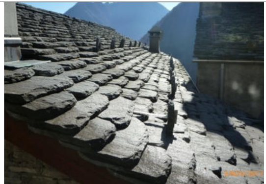
Rossa: nuovo manto in beole di dimensione costante posate a filari rettilinei e perfettamente regolari e con ridotto sormonto tra gli elementi
