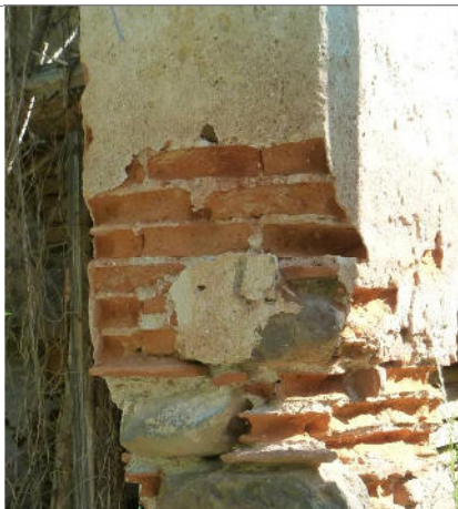
Alveolizzazione ed erosione dei mattoni - Grignasco
