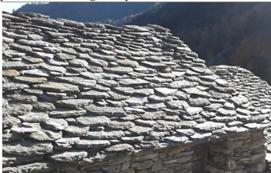
Rossa: vecchio manto in piode di dimensioni e formato irregolare, con la tipica posa 'a mosaico', ossia senza corsi, ma con sistema simile alla posa delle pietre nei muri a secco
