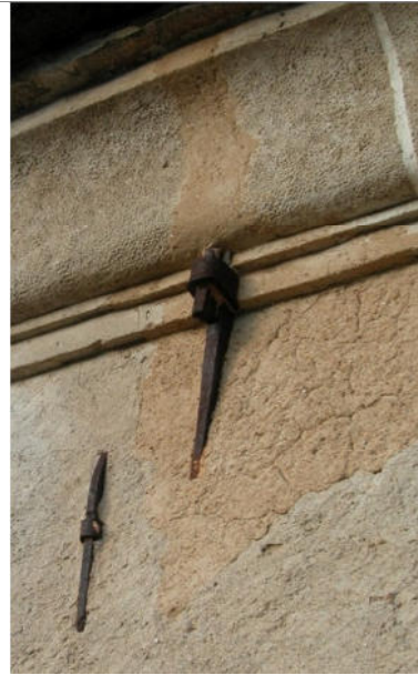
Stesso edificio della foto a sinistra: volonteroso tentativo di realizzare un rappezzo di intonaco imitando la malta originaria: il risultato non è perfetto, ma l'intento è apprezzabile
