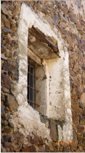
Muro in pietra a secco e cornice e strombatura esterna della finestra in tonachino (calce aerea e sabbia fine)
