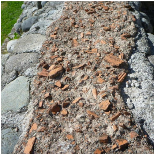
Grossolano tentativo di realizzare una malta addizionata con cocchiopesto: alla calce sono stati mescolati frammenti di dimensioni troppo grandi, non macinati, di laterizi moderni.
