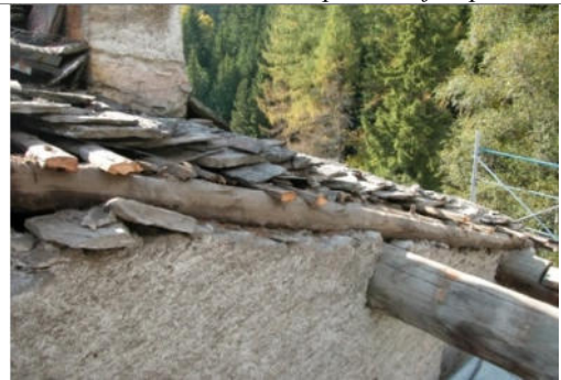
Correnti orizzontali costituiti da elementi mezzo-tondi, posati sui puntoni parallelamente alla linea di gronda, che sorreggono le lastre lapidee. Si nota come la pendenza della falda non influisce sulla pendenza delle piode, che risultano posate quasi in piano
