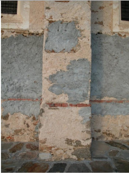
Intonaco originario di colore rosato in malta di calce e sabbia, malamente e sconsideratamente ripreso con rappezzi grossolani in malta cementizia dal tipico colore grigio-azzurro
