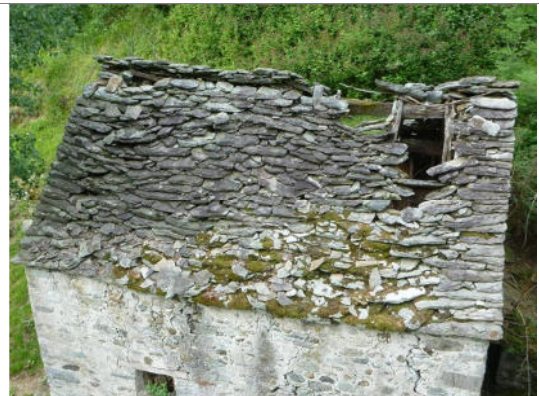
Val Mastallone, Cravagliana, fraz. Molino: tetto in fase di imminente crollo all'interno del fabbricato
